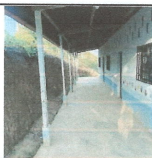
Foto 6: El piso y techo del aula están deteriorados.
