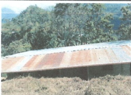
Foto 3: No se cuenta con infraestructura de calidad.
