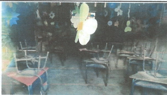
Foto 1: El aula actual no tiene la capacidad para albergar a los niños, las condiciones de la construcción no son aptas.
